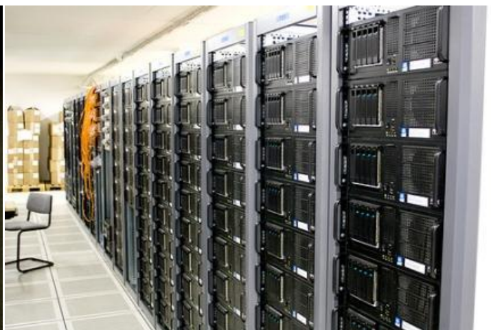
Foto: Internetserverrum med datorstativ.
